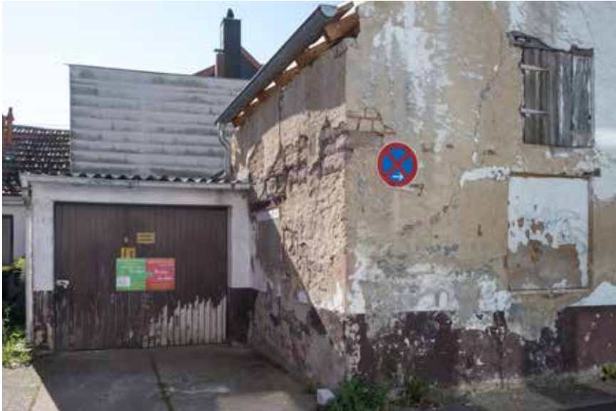
Private Bausubstanz mit hohem Sanierungsbedarf
